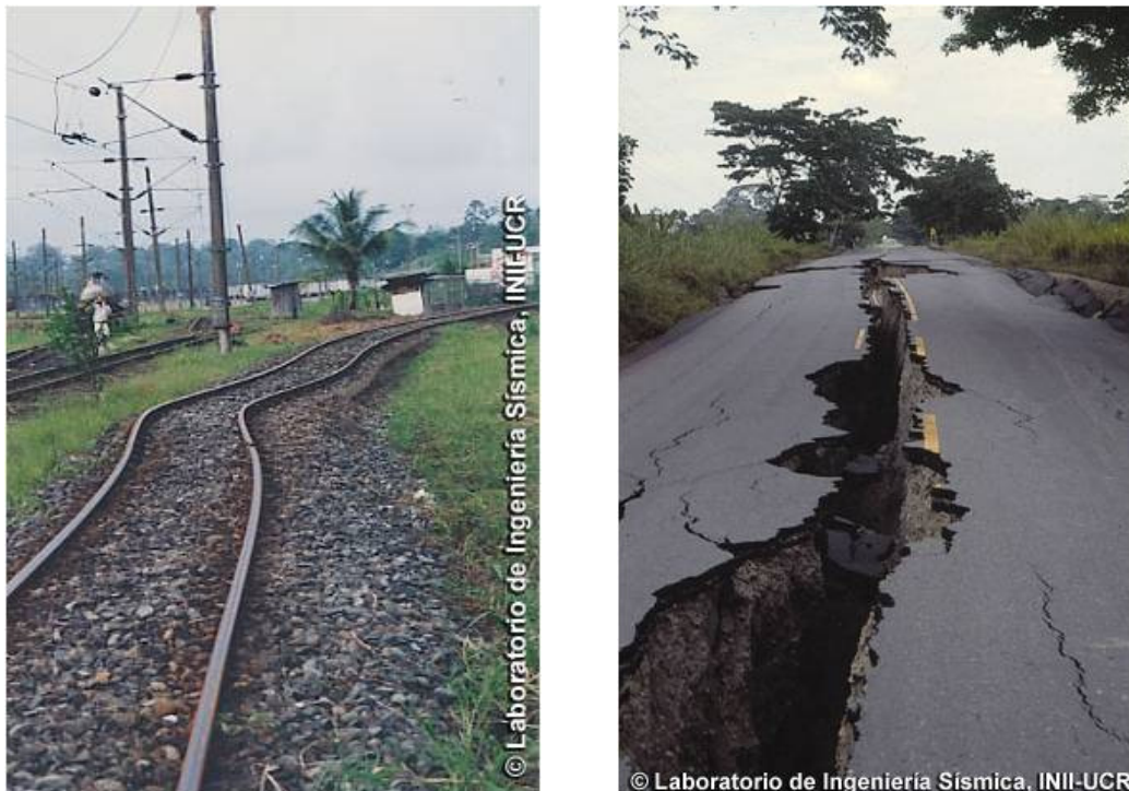
b) Fotografías de estructuras dañadas debido al terremoto de Limón (22/04/91). Corresponden a la modalidad de daños en líneas del tren (intensidad X) y licuación del terreno (intensidad IX-X)
