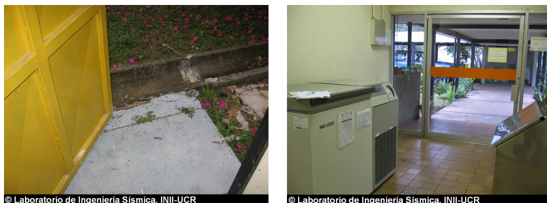
Figura 5. Riesgos adicionales encontrados en el Módulo 1: INISA.
