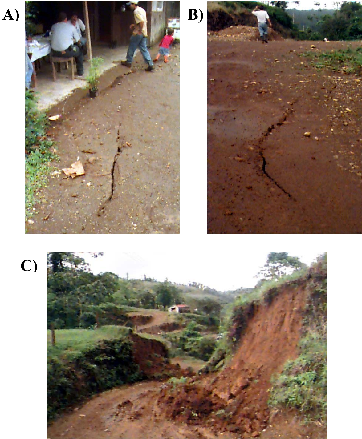
Figura 3: Efectos geológicos debido al sismo de Bijagua en la zona de El Pílon de Upala. A) y B) Pequeñas grietas formadas por asentamiento diferencial en el camino de El Pílon. C). Deslizamientos en el camino de acceso a El Pílon.
